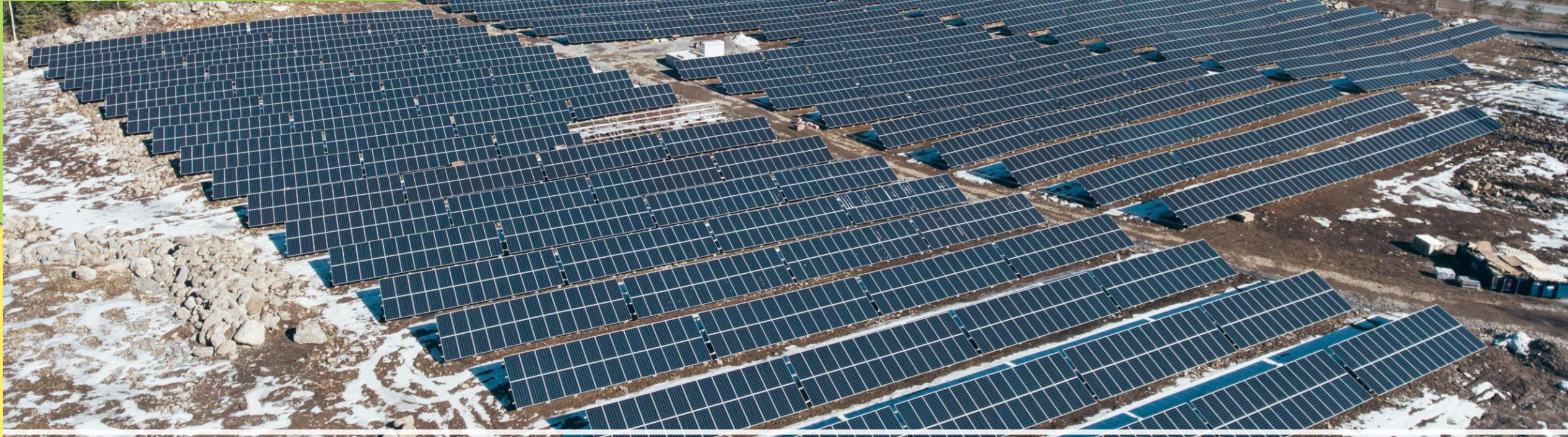
Eteläinen aurinkopaneelientä Teho 2 MW, paneeleita 5 980
